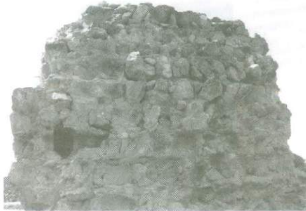
Resim:8 Cemilbey Köyü Camisi. Duvarlardan ayrıntı.
