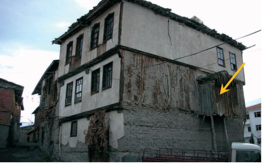
Resim 185 - Ankara-Güdül ilçesi 20. yüzyıl başlarından kalma metruk bir binanın yan bahçeye bakan ikinci katına çıkmalı olarak yapılan tuvalet mekânı. (Tuvalet, ahşap bir destekle yere sabitlenmiş, yanında gider borusu görünüyor)
