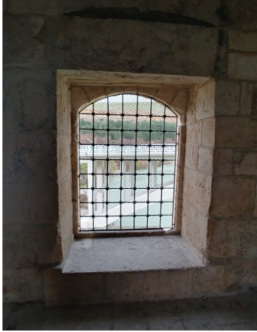
Resim 71 - Köprü pencerelerine sonradan yapılan tel örgü ve parmaklık.
